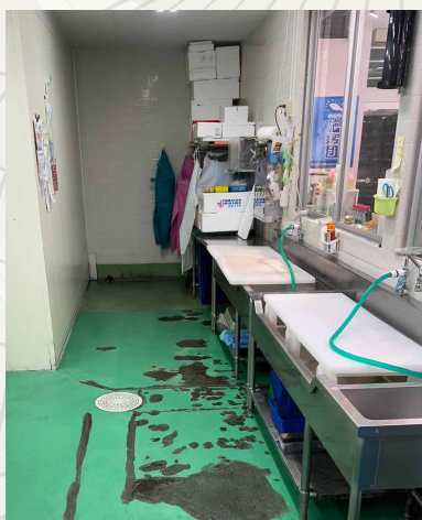
旧塗膜が剥げてコンクリートが むき出しになり水分が浸透、 清掃後ヌレロック塗布
