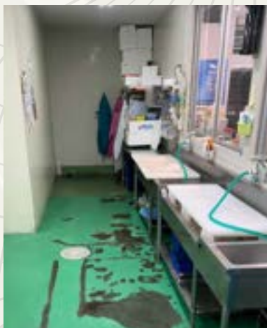
旧塗膜が剥げてコンクリートがむき出しになり水分が浸透、清掃後ヌレロック塗布
